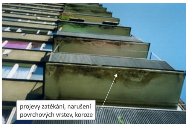
Obr. 49 narušení betonu na spodním líci konzolově vody vyložené desky od zatékání
