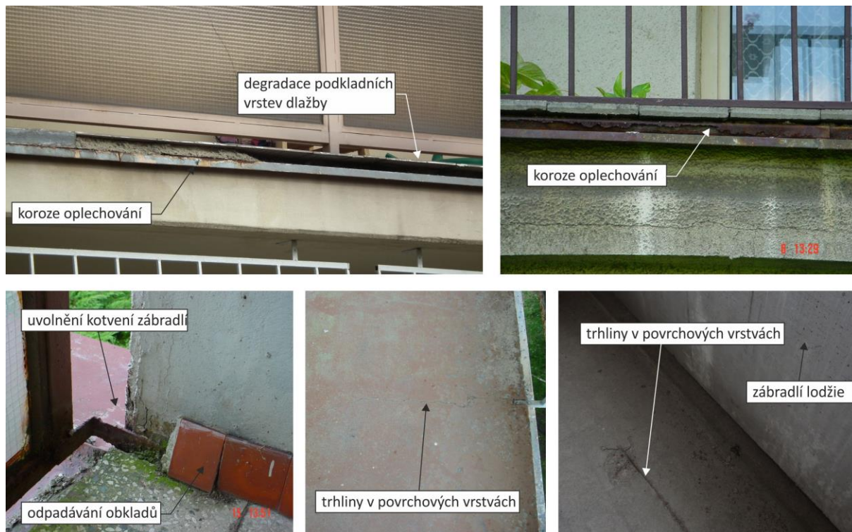
Obr. 57 Příklady vad, poruch a nedostatků podlah, hydroizolací a oplechování balkonů a lodžii
