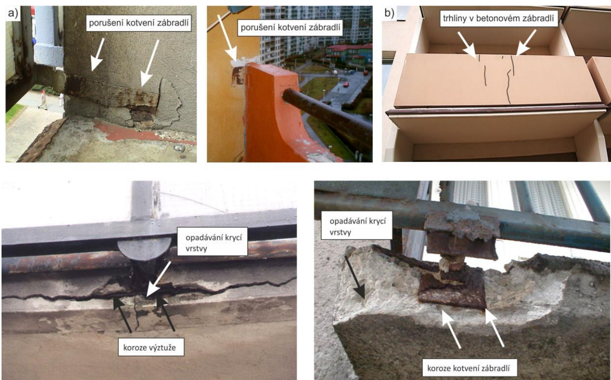
Obr. 23 Příklady poruch způsobených chybným řešením kotvení lodžiových zábradlí – a) koroze kotevních prvků, degradace a opadávání povrchových vrstev stěnových lodžiových dílců vlivem cyklických změn teploty a vlhkosti, b) narušení konstrukce zábradlí, c) koroze kotevních prvků zábradlí, degradace a opadávání povrchových vrstev lodžiových dílců
