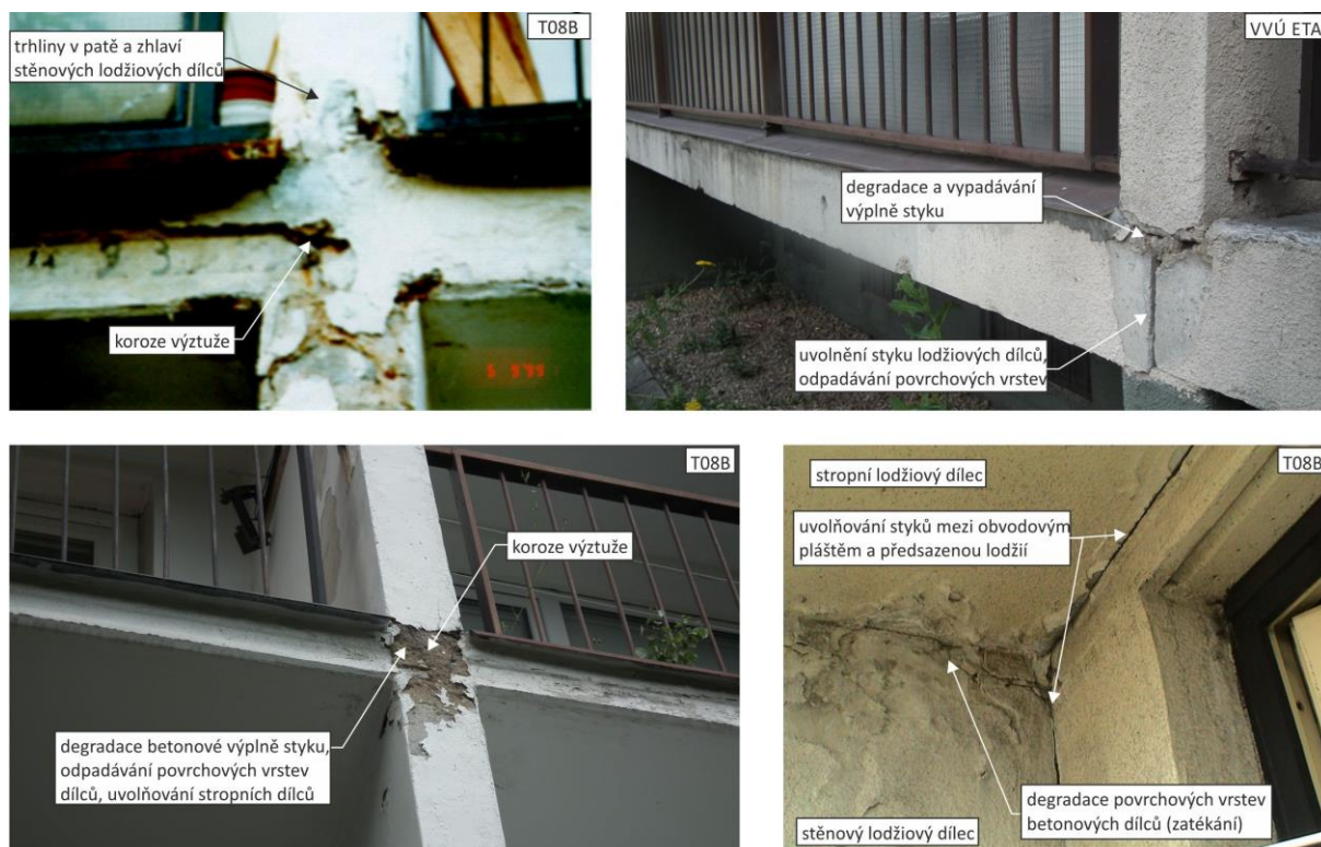
Obr. 6 Poruchy a rozpad betonu zhlaví a pat stěnových a stropních lodžiových dílců (stavební soustava T08B), narušení styku stěnových a stropních dílců cyklickými účinky teploty a vlhkosti, korozí betonu, výztuže a oplechování (stavební soustava VVÚ ETA a T08B)
