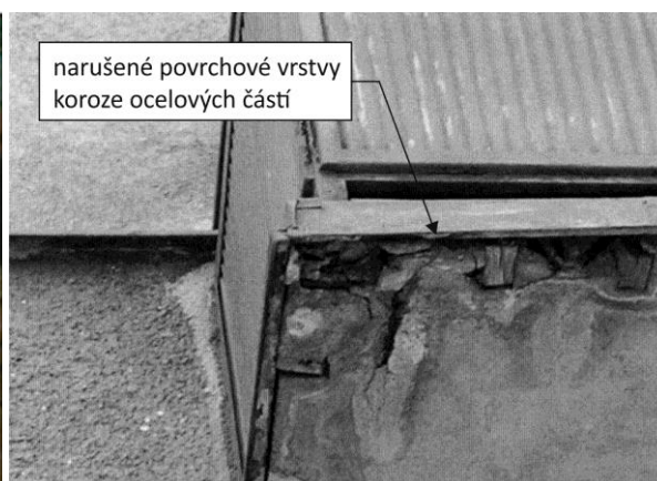
Obr. 47 Chybně řešené kotvení ocelového zábradlí
