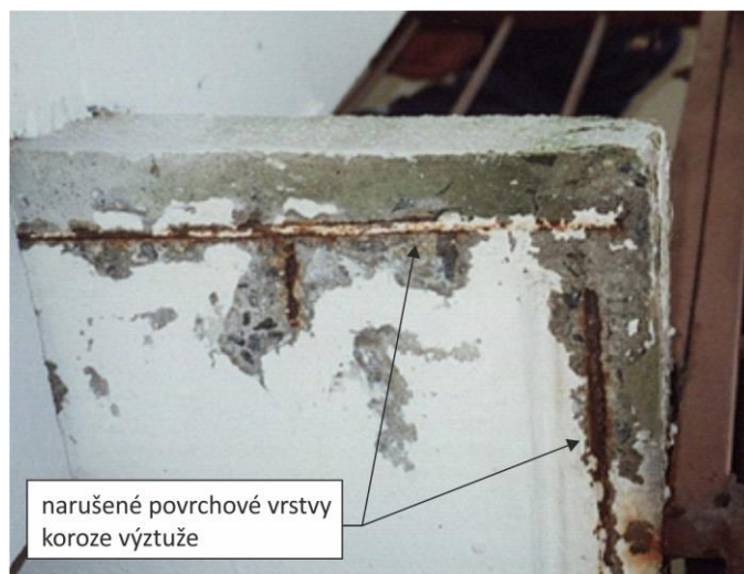
Obr. 16 Narušení stropního lodžiového dílce způsobené nízkou hutností betonu při výrobě a malou krycí vrstvou betonu stavební soustavy B70 (snímek odspodu)
