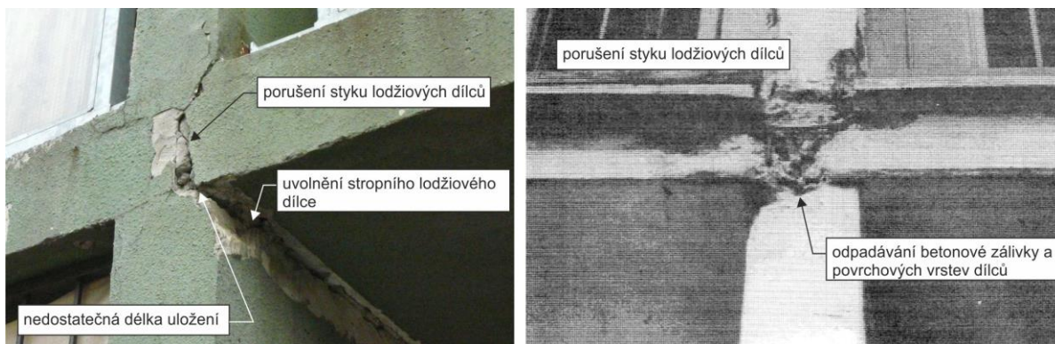
Obr. 19 Příklady porušení styku lodžiových stěnových a stropních dílců
