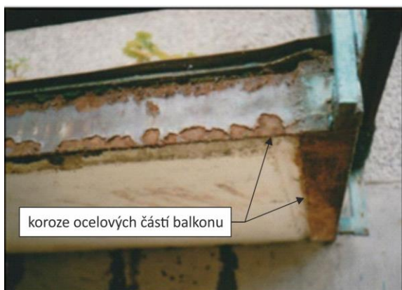
Obr. 48 Nedostatečná ochrana obvodového ocelového rámu proti korozi a zatékání
