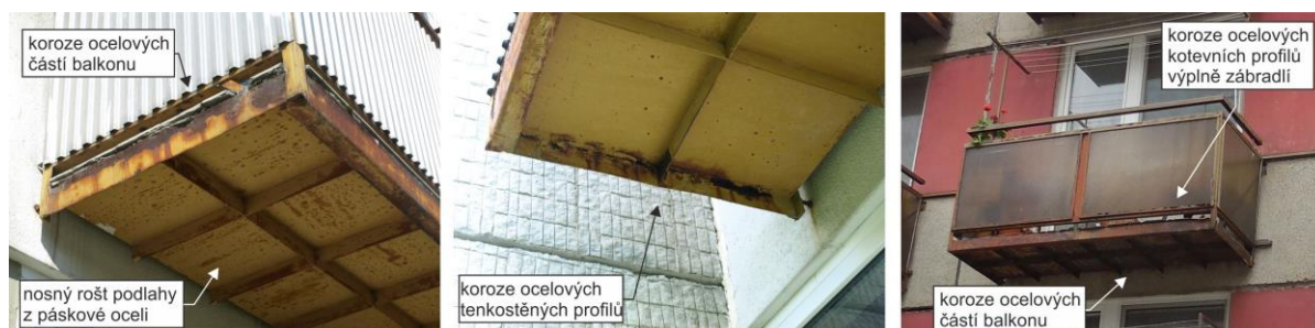
Obr. 54 Konstrukce zavěšených ocelových balkonů, koroze nosných profilů
