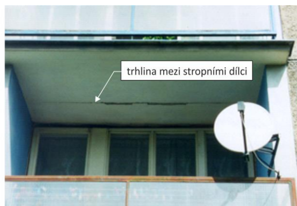
Obr. 11 Trhlina mezi stropními lodžiovými dílci (stavební soustava T06B)
