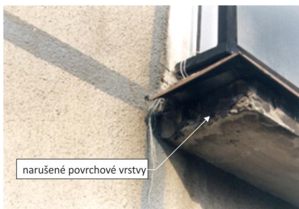
Obr. 10 Narušení povrchových vrstev lodžiových dílců (částečně zapuštěná lodžie, SS T06B)
