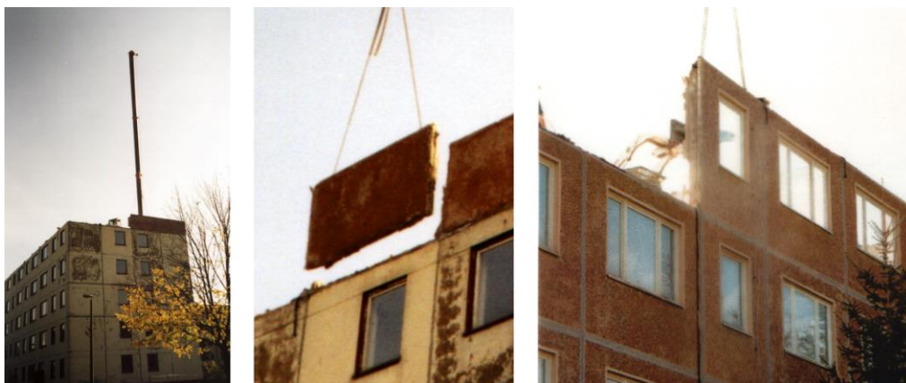
Obr. 55 Demontáž objektu v součinnosti silného jeřábu a lehkého univerzálního stroje pojíždějícího po stropní desce
