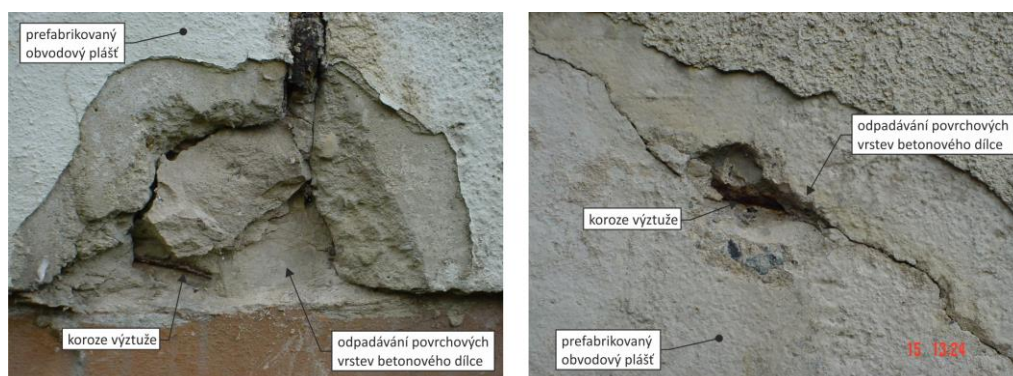
Obr. 2 Narušování, degradace betonu, koroze výztuže obvodových dílců
