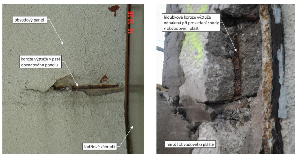
Obr. 3 Narušování obvodových dílců, koroze výztuže
