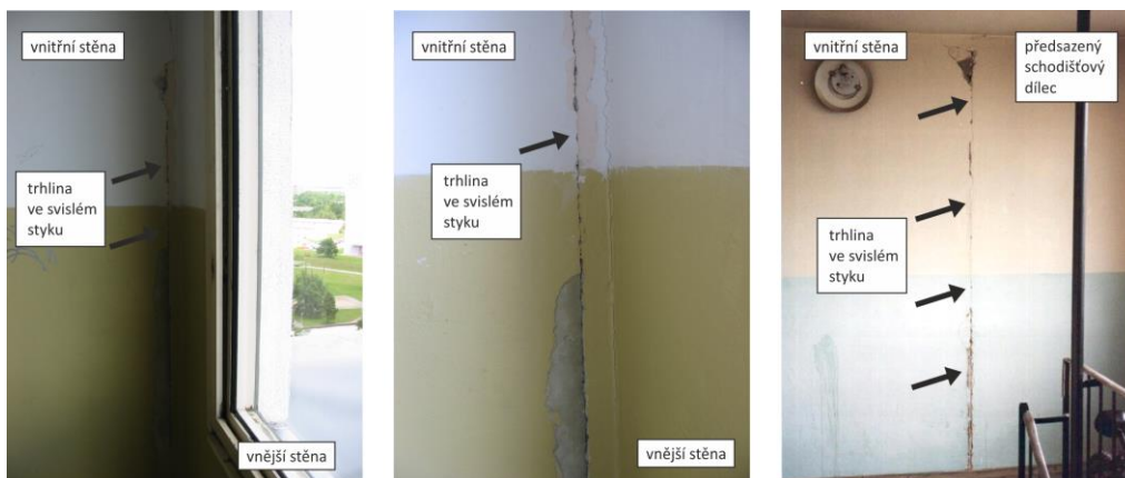
Obr. 25 Porušení svislých styků mezi vnitřními a vnějšími stěnovými dílci
